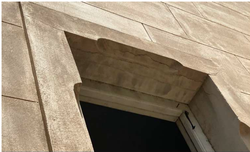
Presencia de fisuras en material de revestimiento símil piedra en dinteles.
