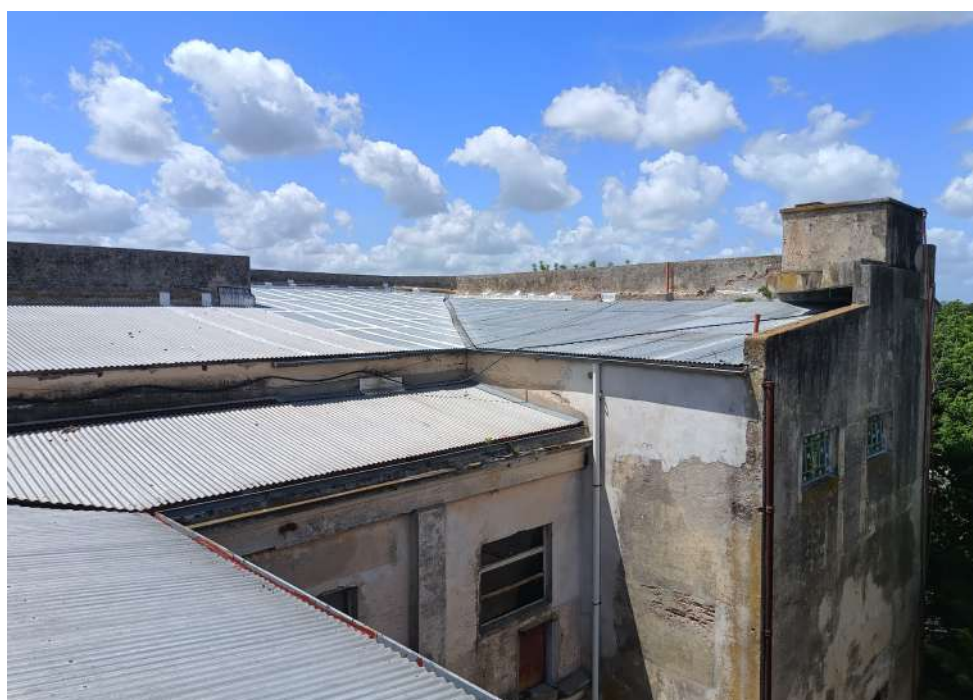
Sistema pluvial incompleto y obsoleto. Faltante de bajadas, canaletas, caños de bajadas.
