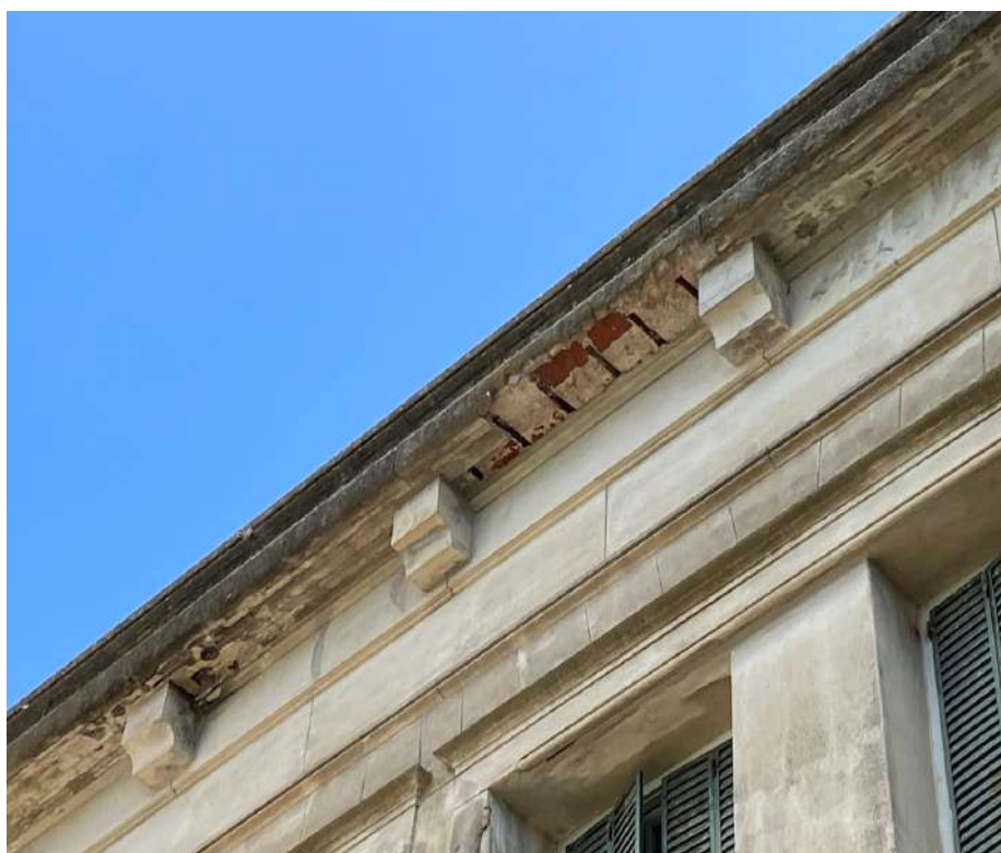
Sector a intervenir en cornisa: hierros expuestos, desprendimiento de revestimiento simil piedra en ménsula perimetral.
