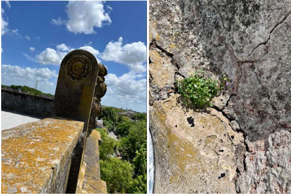
Biofilm: moho, líquenes, musgos, suciedad en cornisas y ornamentos. Biodeterioro en Grietas y fisuras.
