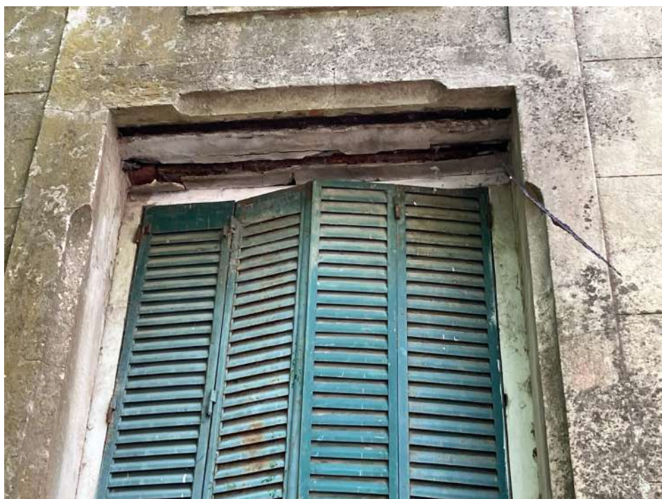
Dinteles con hierros expuestos. Pérdida de material de revestimiento.
