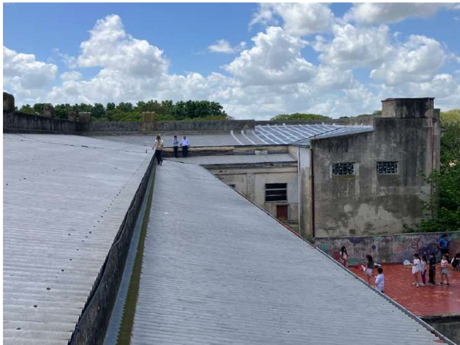
Sector a intervenir a la derecha en cubierta de chapa emparchada.
