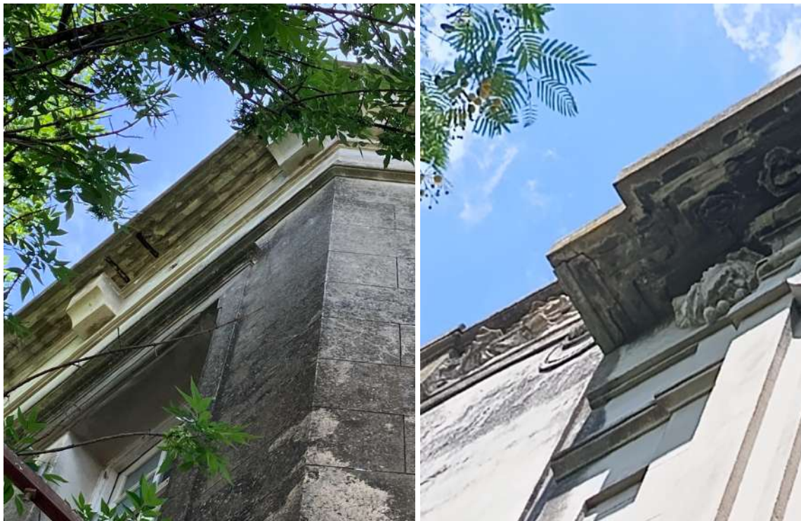
Sector a intervenir en cornisa: hierros expuestos, desprendimiento de revestimiento simil piedra en ménsula perimetral. Fisuras y grietas
