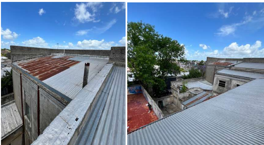
Sector a intervenir, reemplazo de cubiertas de chapa oxidadas
