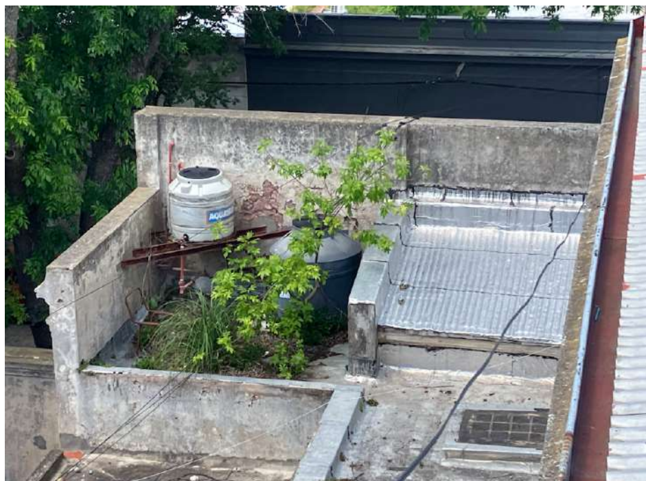
Sector a intervenir en cubierta plana: biodeterioro, presencia de vegetación invasiva.
