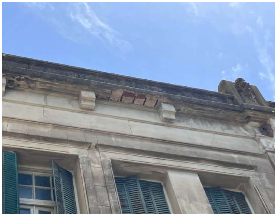
Sector a intervenir en cornisa: desprendimiento de revestimiento revoque símil piedra.
